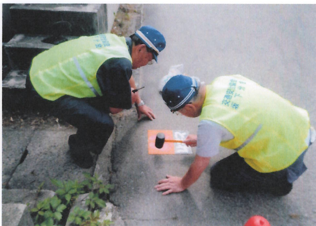
飛び出し注意 止まれ看板の設置
